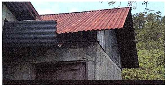
Foto 4: TECHO DE COCINA EN MAL ESTADO.
