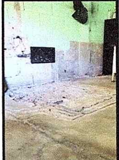
Foto 6: PISO Y PARED DE DIRECCIÓN EN MAL ESTADO
