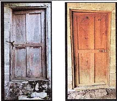
Foto 3: PUERTAS DE COCINA EN MAL ESTADO.
